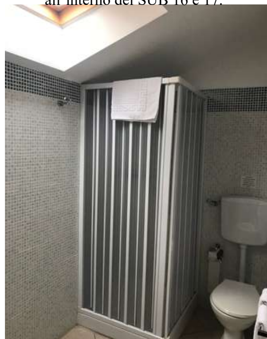
Foto 55. SUB 16. Servizio igienico realizzato in difformità al progetto approvato.
