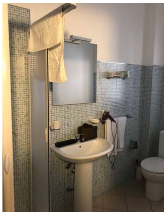
Foto 31. SUB 10. Servizio igienico realizzato in difformità al progetto approvato.
