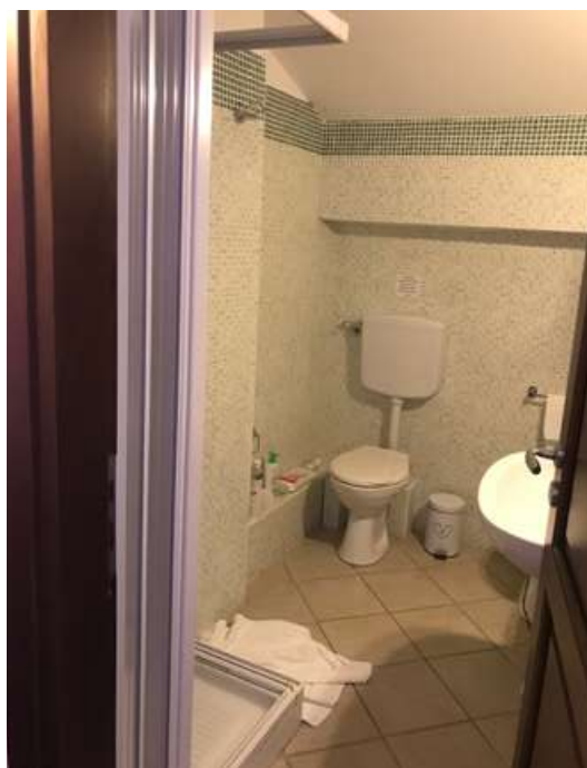
Foto 58. SUB 17. Servizio igienico realizzato in diffomità al progetto approvato.
