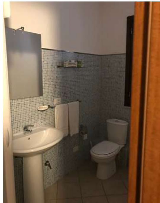
Foto 47. SUB 14. Servizio igienico realizzato in difformità al progetto approvato.
