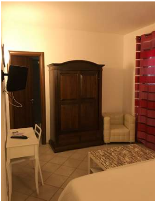
Foto 46. SUB 14. Tramezzo realizzato in difformità al progetto approvato.
