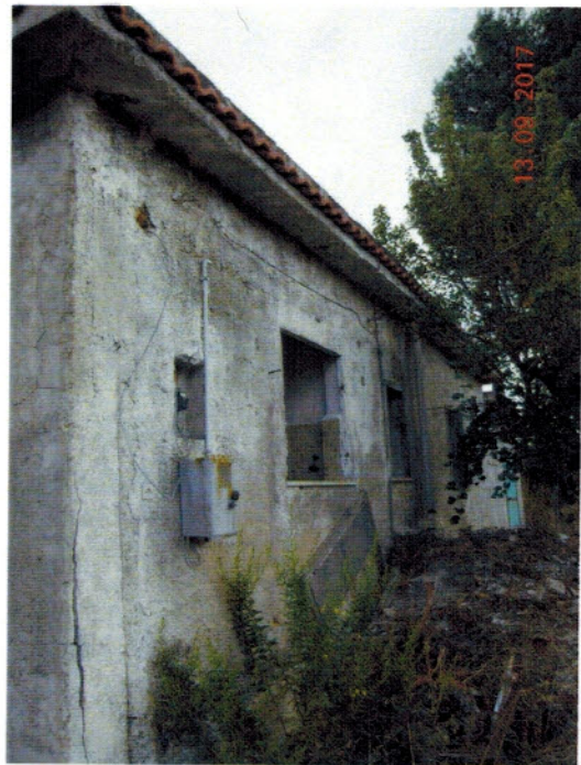
Mancano alcuni infissi esterni dei vani
