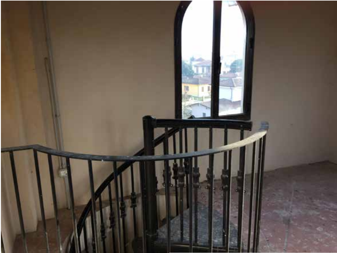
foto 23 - vista interna torretta
