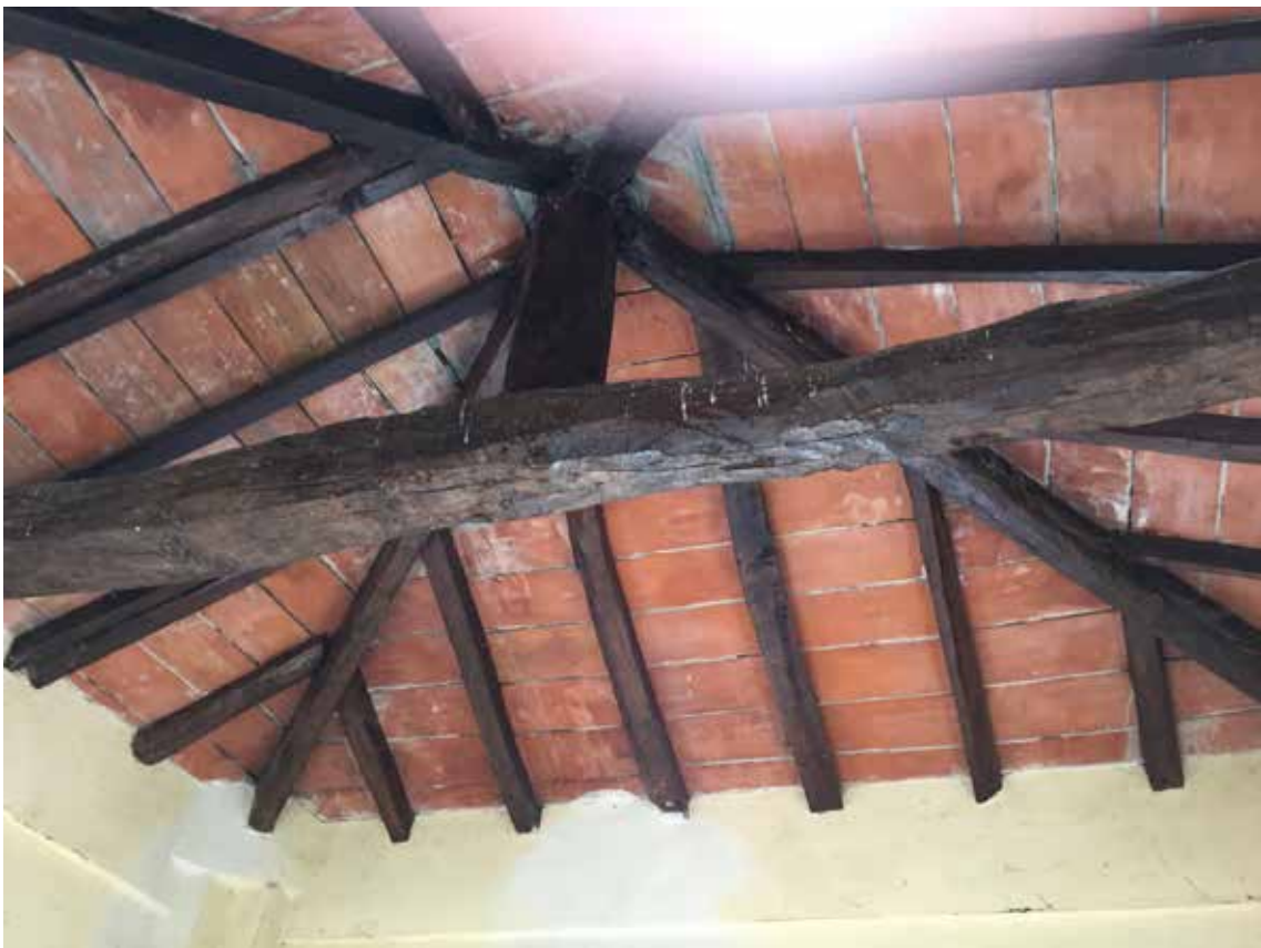
foto 24 - vista interna torretta
