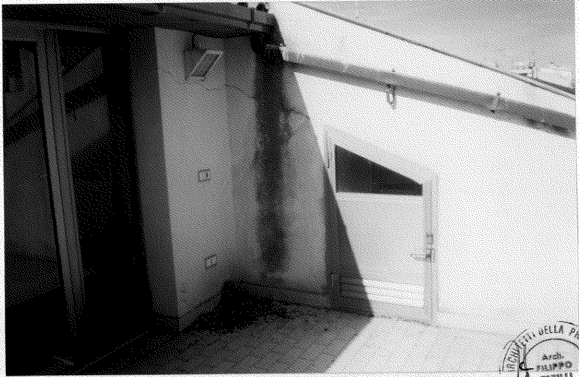
(foto n. 62) Le condizioni del terrazzo e delle murature
