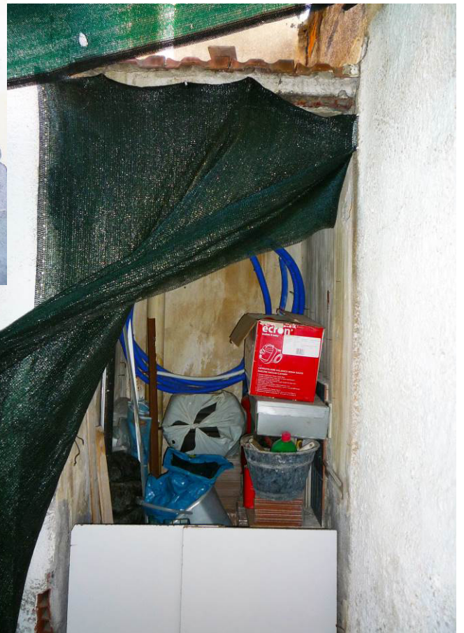
Foto 18. Immobile I1: locale tecnico.
