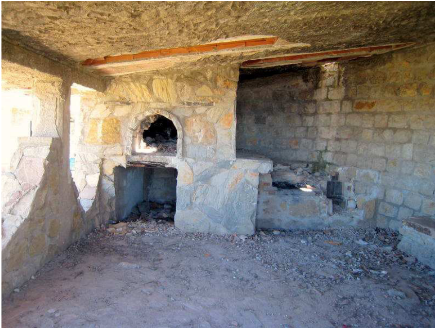
Foto n. 8. L'interno della tavernetta Tutte le pareti sono rivestite in pietra di vario tipo. Porzione del solaio sopra la "bocca" del forno è "scoppiato".
