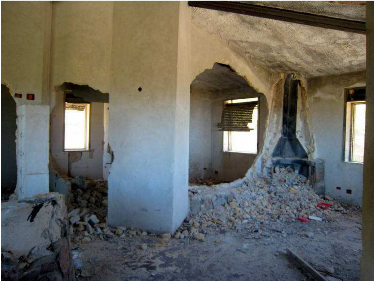
Foto n. 25. Il soggiorno è anch'esso distrutto.
