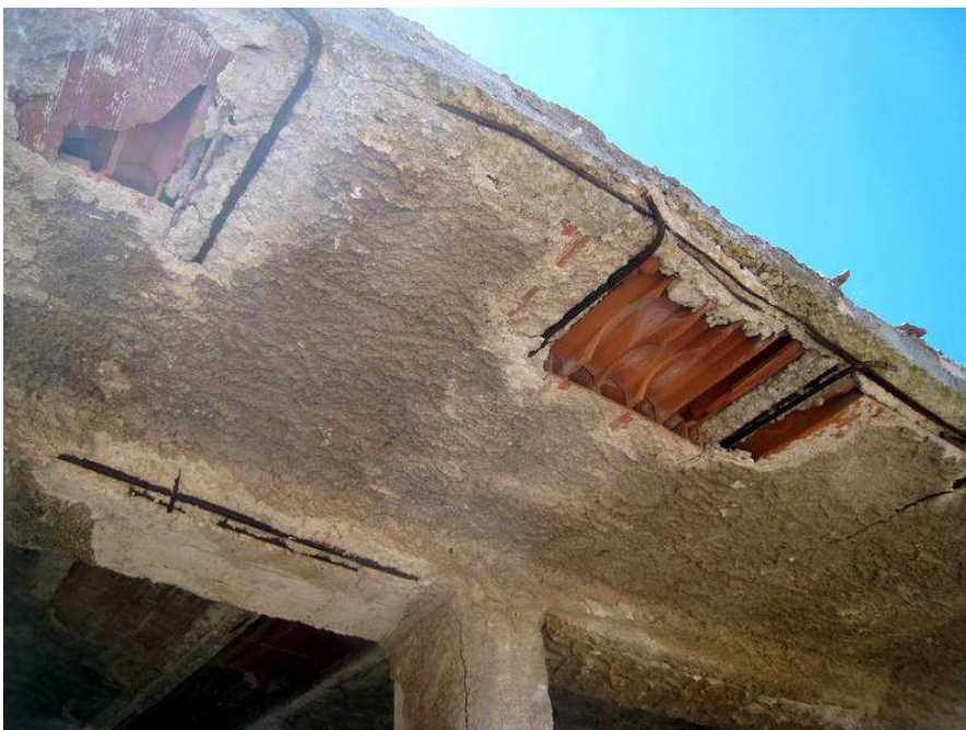
Foto n. 10. La struttura in c.a. è danneggiata in più punti, il calcestruzzo copri ferro è scalzato, le barre di armatura fortemente ossidate e con una significativa riduzione della sezione reagente.
