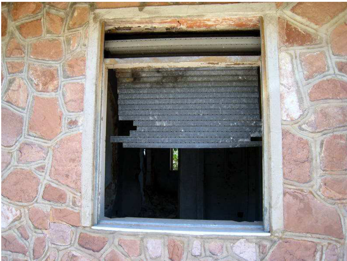
Foto n. 17. Dettaglio di una delle "finestre". Tutte le soglie in marmo sono sbrecciate e/o lesionate.
