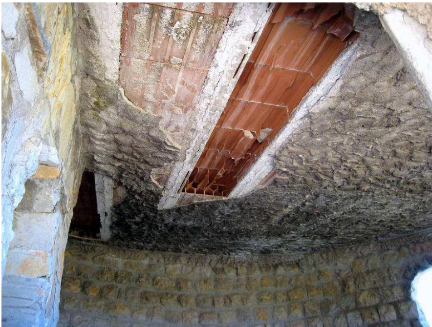
Foto n. 9. A motivo delle infiltrazioni d'acqua meteorica, facilitate dalla mancanza delle tegole sul tetto, il solaio è in cattive condizioni e "scoppiato" in più punti. Gli intonaci, inoltre, sono ammalorati.
