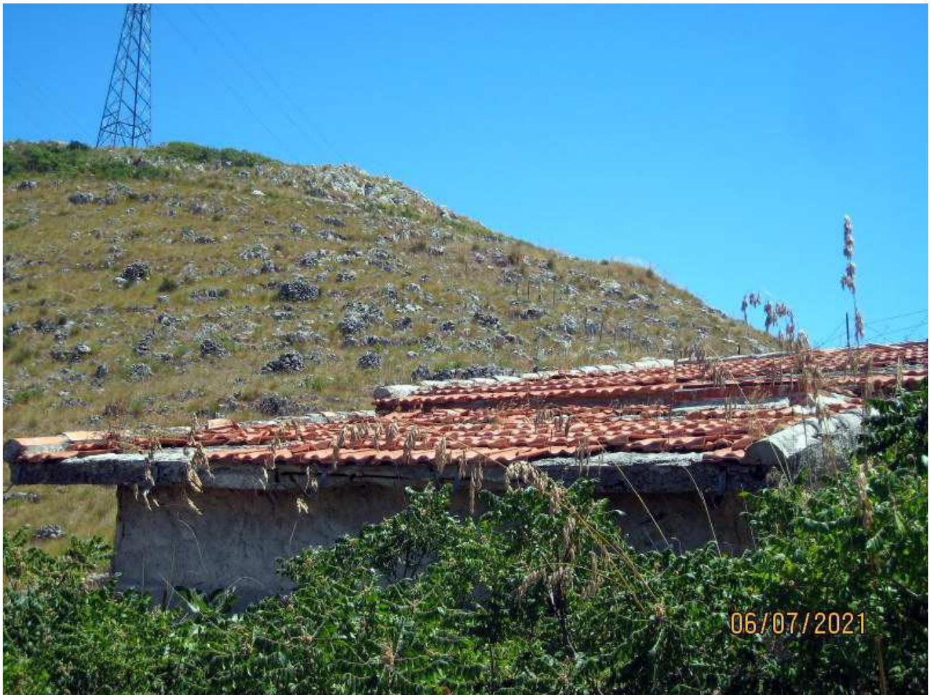
Foto n. 36. Il tetto della vasca idrica e del magazzino manca di molte tegole.
