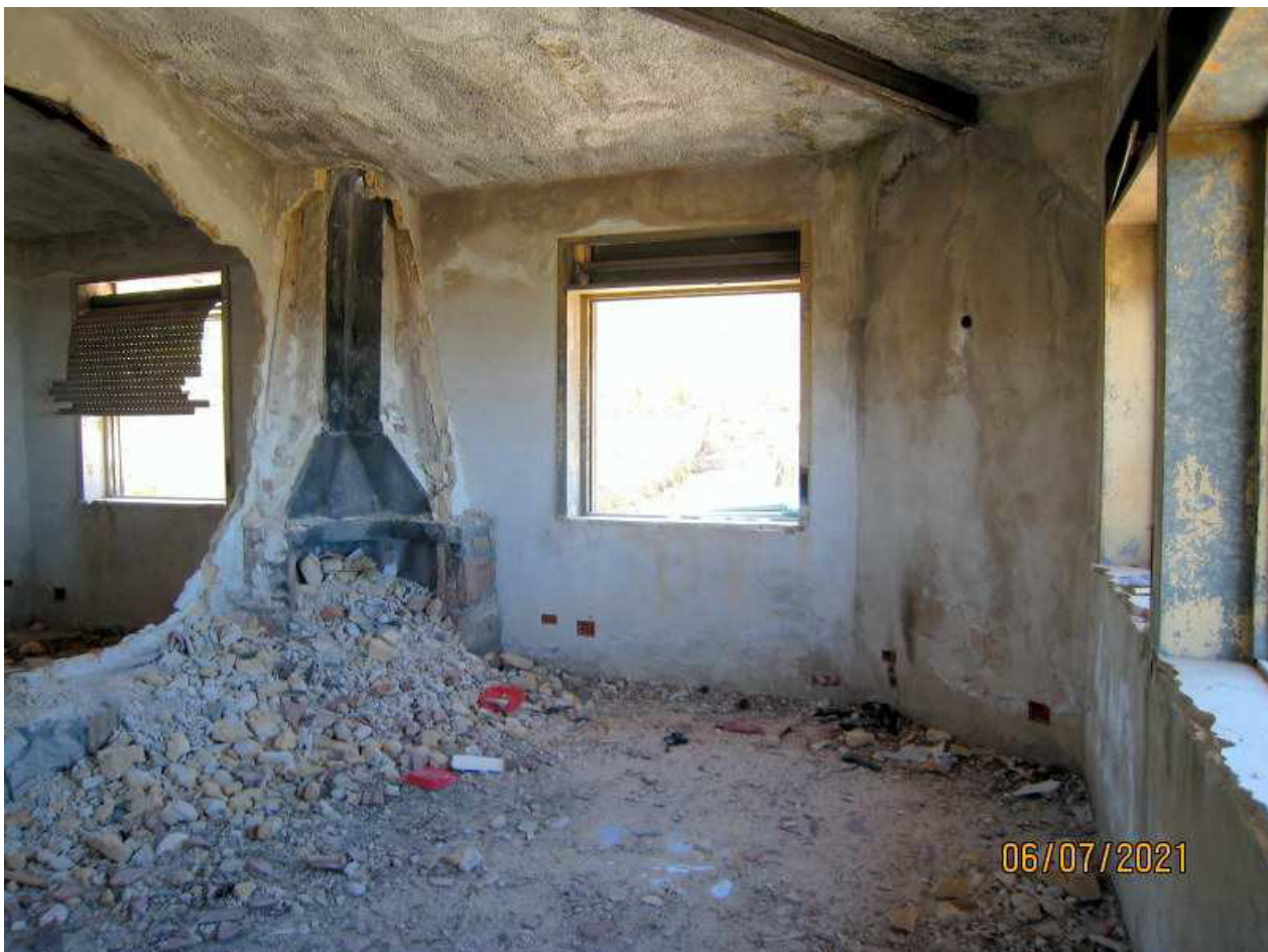
Foto n. 26. Il camino è stato “strappato” dal suo alloggiamento. Umidità e muffe diffuse sulle pareti.
