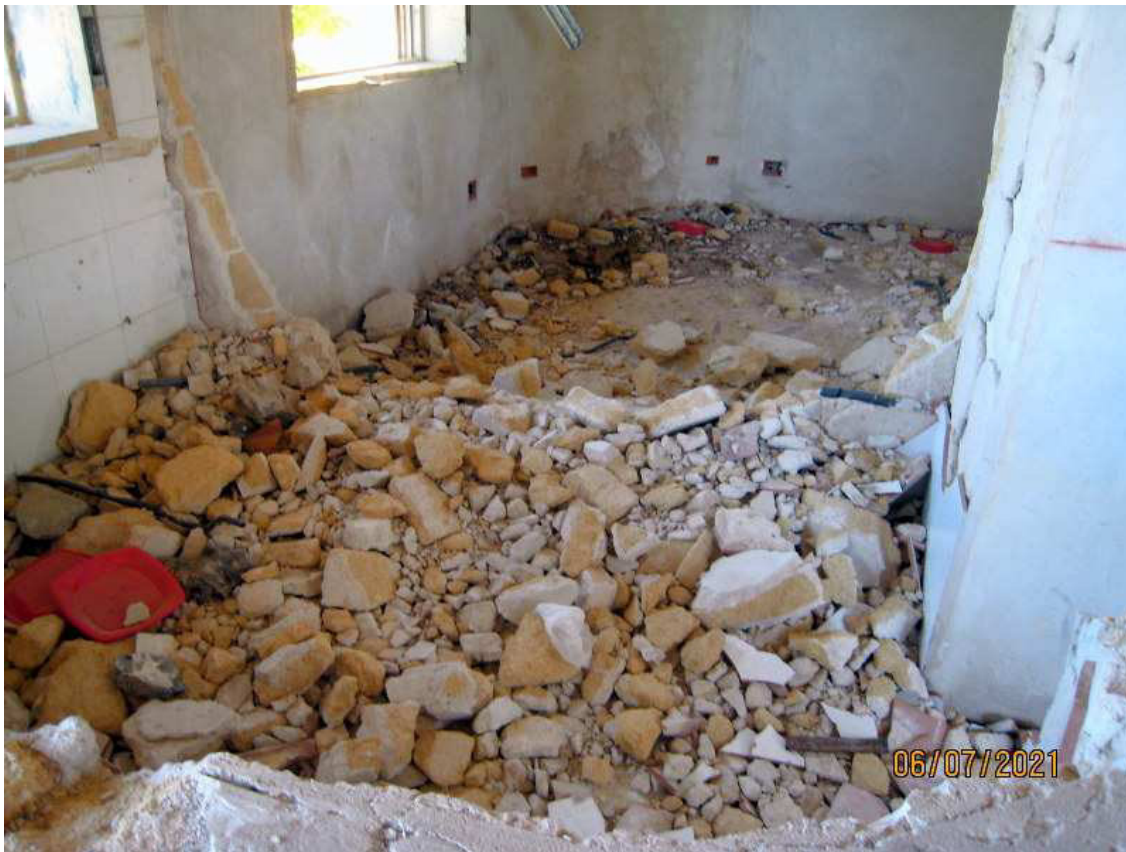
Foto n. 22. Gli sfabbricidi depositati sul pavimento. Dell'impianto elettrico non esiste più nulla.
