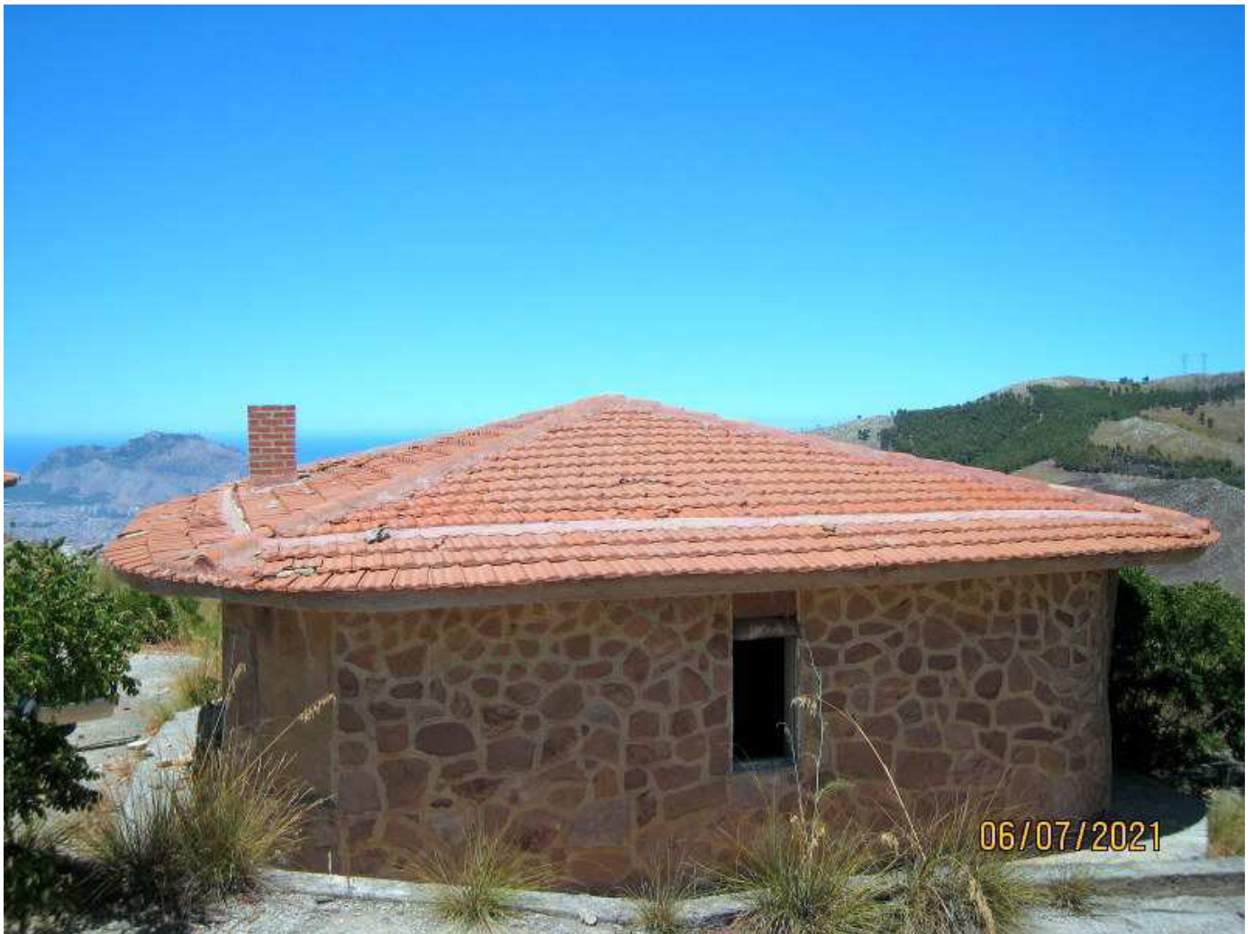
Foto n. 16. Sul tetto mancano parecchie tegole ed altre sono frantumate.
