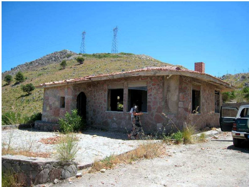
Foto n. 12. La villetta è priva di tutti i serramenti esterni perché sono stati rubati. La pensilina in copertura è ammalorata a causa della pioggia. La foto mostra il prospetto Nord (a Sx) e quello Ovest (a Dx).
