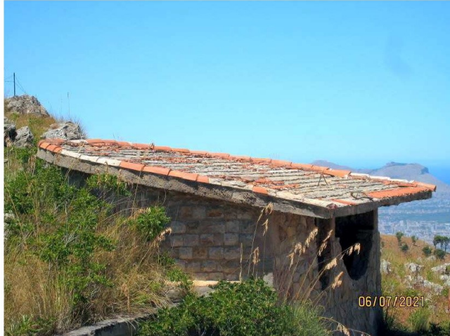
Foto n. 11. Sul tetto sono rimaste poche tegole e non vi è guaina di protezione contro le infiltrazioni.
