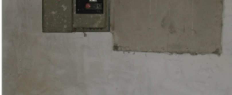
Locale a piano terra contatore ENEL.
