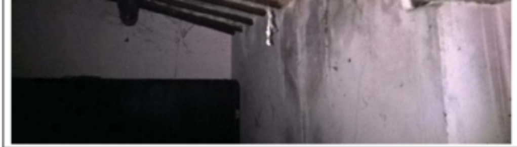
Particolare copertura in rovina
